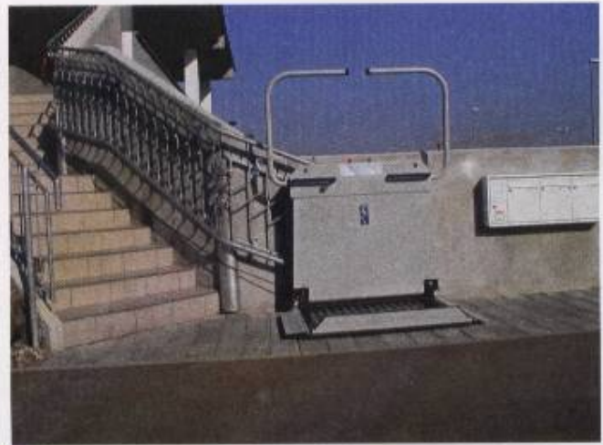
► T80 Aussenanlage mit feuerverzinkter Fahrschiene
